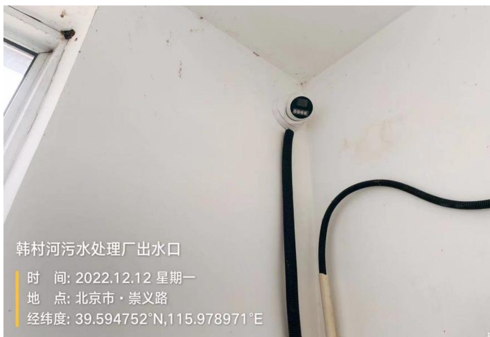
场站监控设备照片
