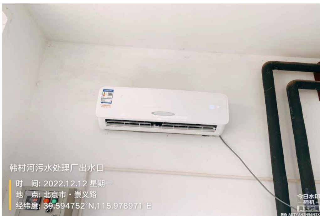
站房空调和稳压电源照片
